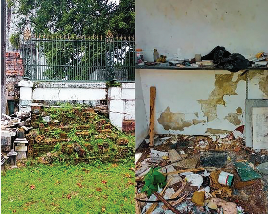
Figura 2 – Entulhos depositados ao lado do jazigo da Irmandade do Santíssimo Sacramento e no interior de um antigo jazigo
